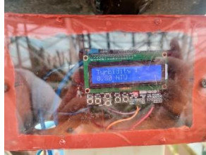
Gambar 16. Rangkaian terpasang di dalam kotak panel
