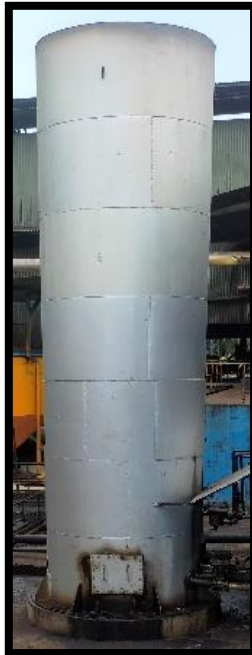
gambar 1. 2 Condensat Chamber (Sumber. Dokumentasi Penulis)
