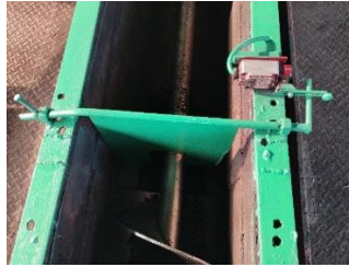
Gambar 13. Model Pemasangan Bandul dan Limit switch
