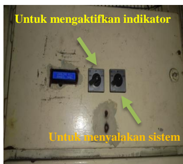
Gambar 7 Panel sistem peringatan dini
