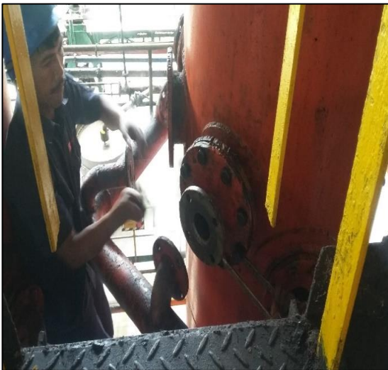
Pengecekan kondisi dalam vacuum dryer
