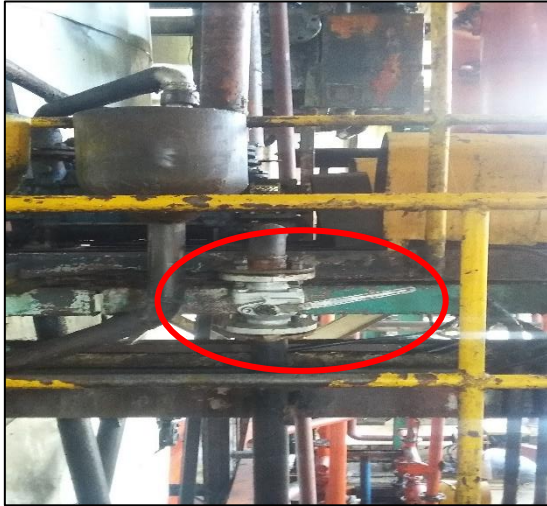
Pengaturan tekanan vakum pada valve pompa vakum
